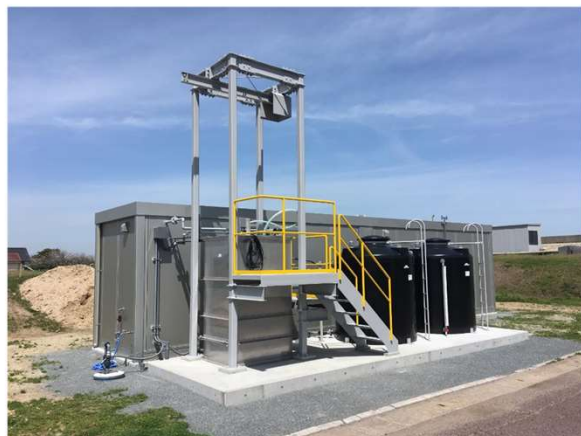
築上町液肥濃縮施設(令和3年3月完成)
