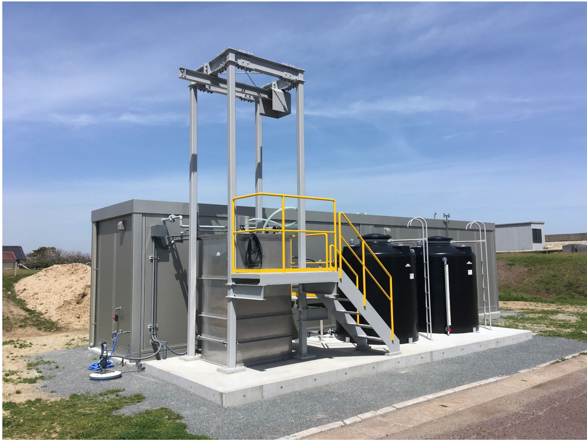
築上町液肥濃縮施設(令和3年3月完成)
