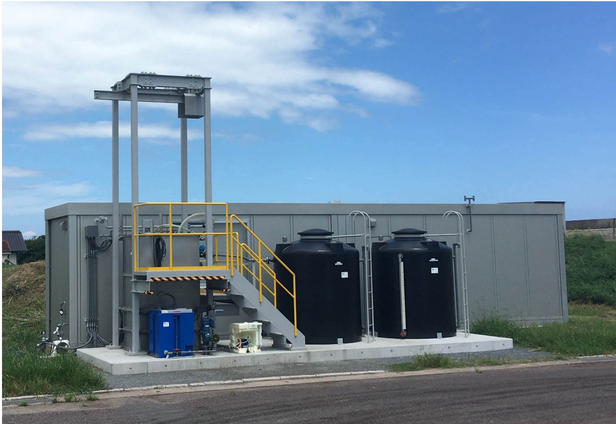
(共研プロジェクト実施場所) 築上町液肥濃縮施設
