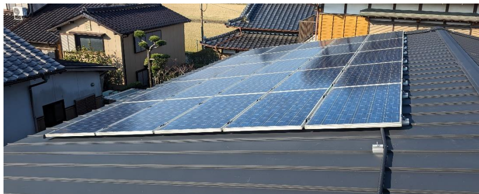
1階屋根設置パネル
