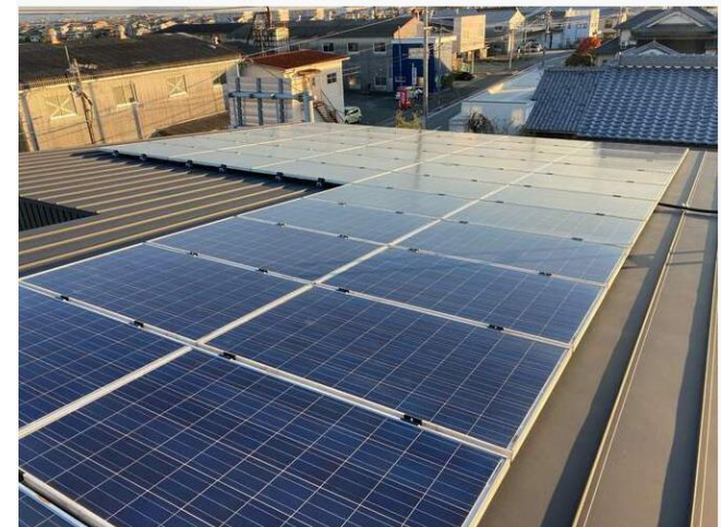
2階屋根設置パネル
