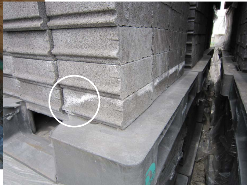
コンクリートの白色析出物
