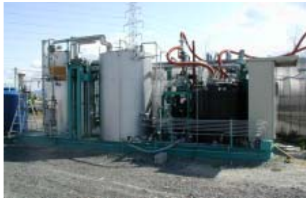
リサイクルセンターに設置したバイオガスプラント
