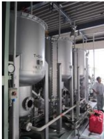
BDF製造プラント グリセリン分離槽
