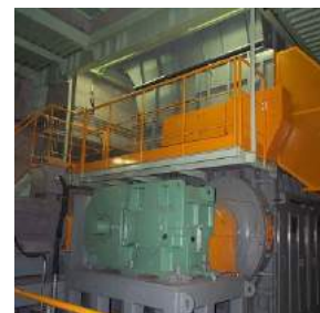
廃プラ処理設備
