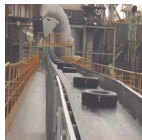
廃タイヤ投入設備
