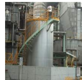
廃油受入設備
