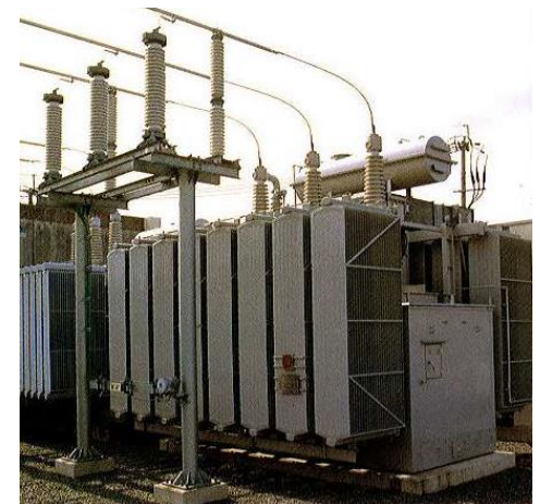
大型変圧器(地上設置)
